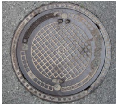
Über 25 km Abwasserkanäle liegen unter unseren Straßen - und müssen erhalten werden!
